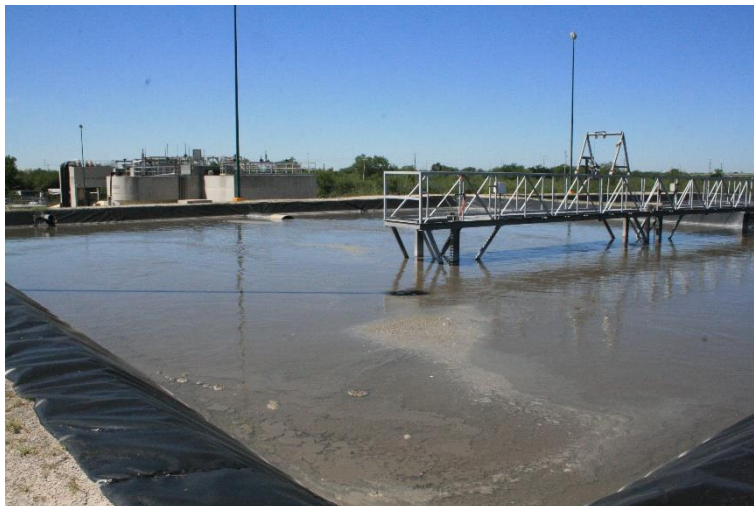
REACTOR ANÓXICO. PERMITE LA MEZCLA DEL LODO DE RECIRCULACIÓN CON LAS AR.
