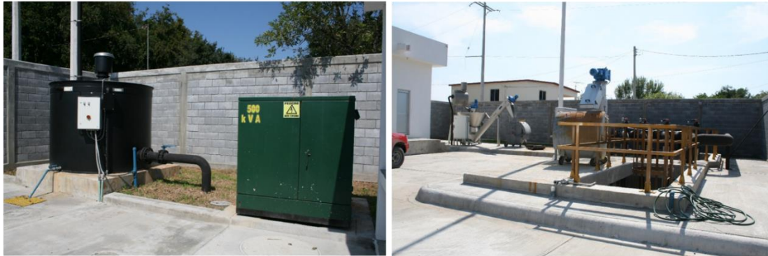
(IZQ) EQUIPO LAVADOR DE GASES PRODUCTORES DE MALOS OLORES PROVENIENTES DE LAS AR DEL CÁRCAMO DE RECOLECCIÓN Y BOMBEO A LAS LAGUNAS. (DER) EQUIPO DE TRATAMIENTO DE AR: CRIBADO Y DESARENACIÓN CON LAVADO DE ARENAS.
