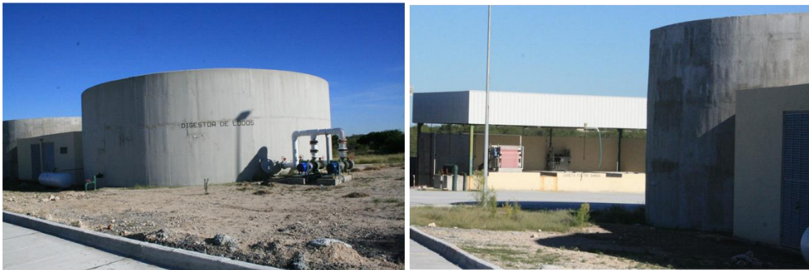
(IZQ) DIGESTOR ANAERÓBICO DE LODOS, EN EL QUE SE ESTABILIZAN LOS LODOS PRIMARIOS Y SECUNDARIOS. (DER) CASETA DE LOS FILTROS BANDA PARA LA DESHIDRATACIÓN DE LOS LODOS ESTABILIZADOS.
