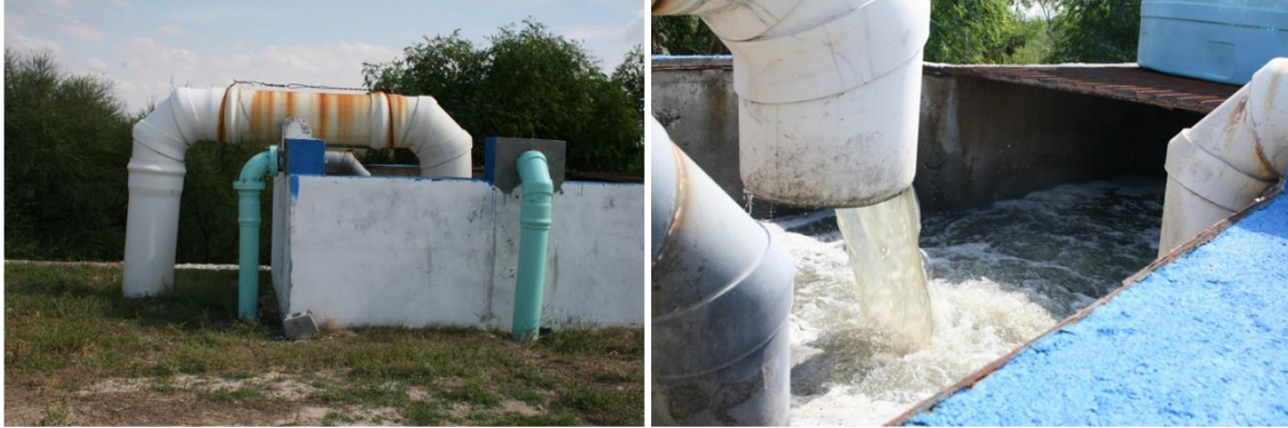
(IZQ) CAJA DE RECEPCIÓN DE AR. (DER) CANAL DE CONDUCCIÓN DE LA CAJA AL MEDIDOR PARSHALL.
