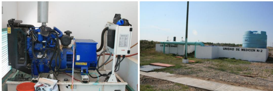
(IZQ) EQUIPO PARA LA GENERACIÓN DE ENERGÍA ELÉCTRICA PARA SU USO EN CASOS DE ENMERGENCIA. (DER) CÁRCAMO DE BOMBEO DE AGUAS RESIDUALES TRATADAS Y UNIDAD DE MEDICIÓN DE GASTO.
