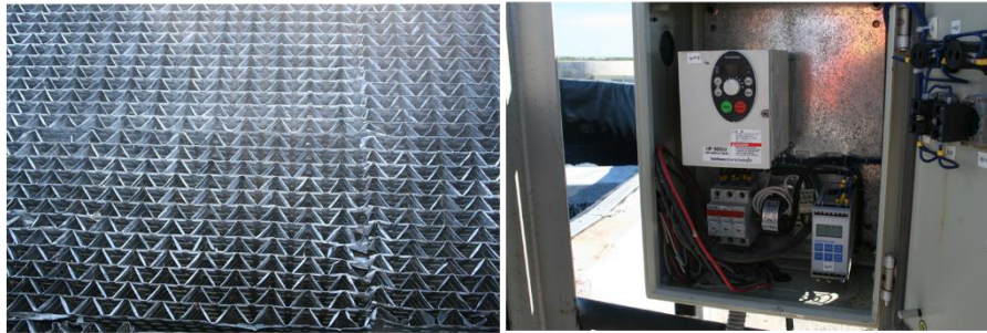
(IZQ) FILTRO BIOLÓGICO, MOSTRANDO LOS MÓDULOS DE EMPAQUE, EN LOS QUE SE APRECIA LA AUSENCIA DE BIOMASA. (DER) SE OBSERVA EL INSTRUMENTO QUE PERMITE CONTROLAR LA VELOCIDAD DEL BRAZO REPARTIDOR DE AGUAS EN EL FILTRO BIOLÓGICO.
