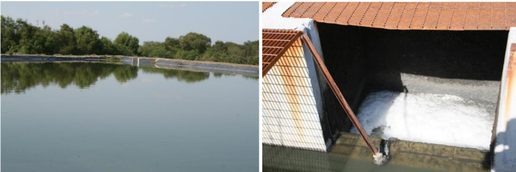
(IZQ) CAJA DE RECEPCIÓN DE AGUAS DE LA LAGUNA DE MADURACIÓN HACIA EL CÁRCAMO DE BOMBEO. (DER) CAJA DE PASO DE AGUAS AL CÁRCAMO DE BOMBEO
