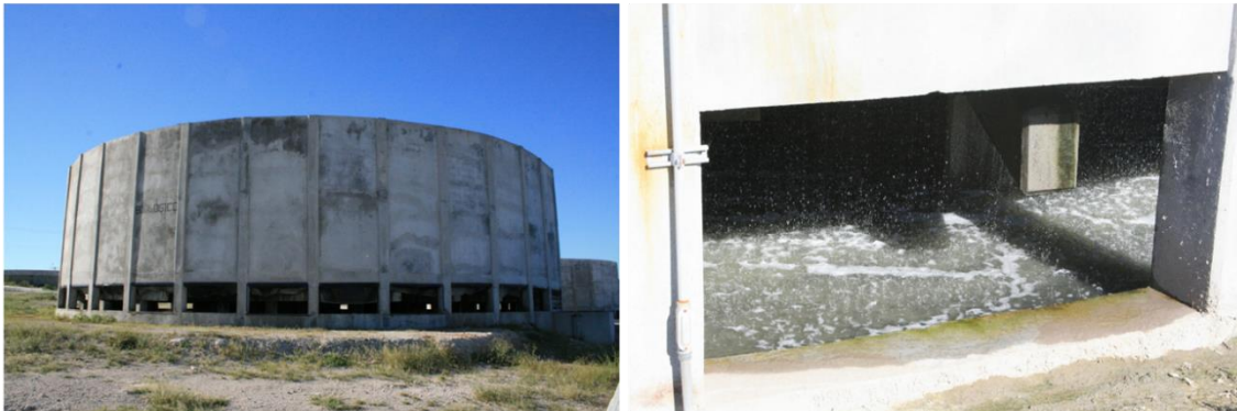
(IZQ) FILTRO BIOLÓGICO, QUE PERMITE APRECIAR SUS DIMENSIONES DE DIÁMETRO Y ALTURA. (DER) SE OBSERVA LA ESTRUCTURA POR LA QUE SE DESCARGAN LAS AGUAS A SU PASO POR EL MEDIO SINTÉTICO. NO SE RECIRCULAN AGUAS EFLUENTES NI DE LOS SEDIMENTADORES SECUNDARIOS.
