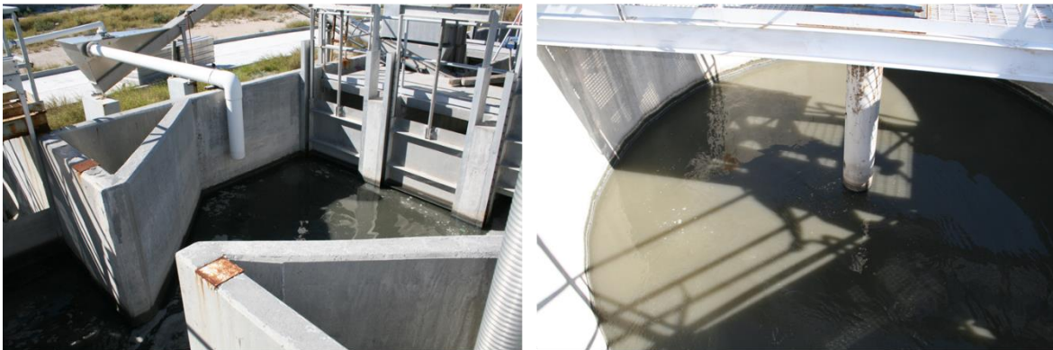
PRETRATAMIENTO. DESARENADOR CENTRÍFUGO. SE OBSERVA EL PASO DEL AGUA PROVENIENTE DEL CRIBADO.
