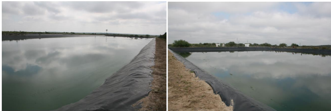
VISTA PANORÁMICA DE LAS LAGUNAS. LA PROTECCIÓN DE LAS GEOMEMBRANAS SE DA A LOS TALUDES PERO NO A LA BASE DE FONDO DE LAS LAGUNAS.
