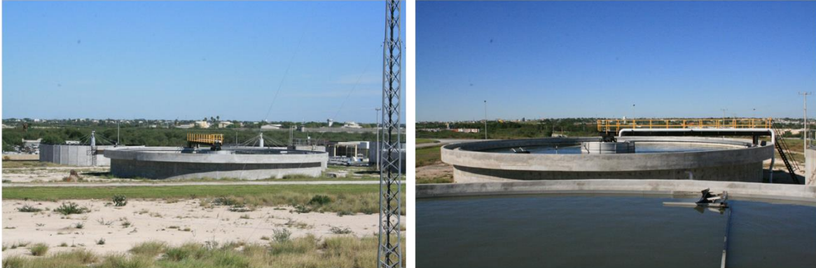
(IZQ) SEDIMENTADOR PERIMARIO, FILTRO BIOLÓGICO Y SEDIMENTADOR SECUNDARIO. (DER) SEDIMENTADOR PRIMARIO Y ESPEJO DE AGUA)
