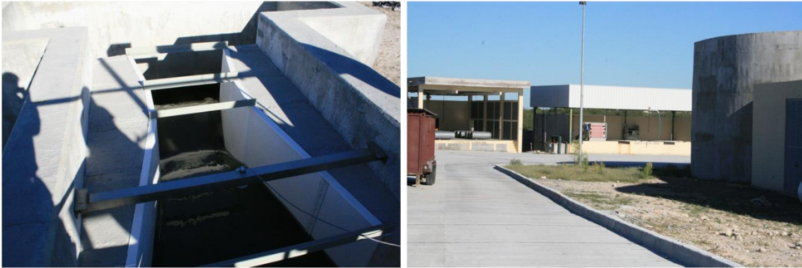
(IZQ) MEDIDOR PARSHALL PARA EL AFORO DE LAS AGUAS RESIDUALES TRATADAS, PROVENIENTES DE DESINFECCIÓN. (DER) SE APRECIA LA CASETA DE CLORACIÓN Y DEL EDIFICIO DE FILTROS BANDA PARA EL DESAGUADO DE LODOS.
