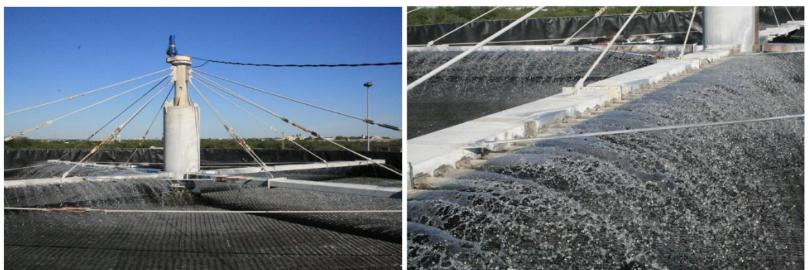
(IZQ) FILTRO BIOLÓGICO, MOSTRANDO EL BRAZO REPARTIDOR DE AGUAS TRATADAS A NIVEL PRIMARIO SOBRE MÓDULOS. (DER) SE OBSERVA UN SOBREFLUJO DE AGUAS QUE LAVA LA BIOMASA DE LAS PAREDES DE LOS EMPAQUES. SE ENCUENTRA EN ETAPA DE ARRANQUE Y ESTABILIZACIÓN, POR LO QUE SERÍA RECOMENDABLE DISMINUIR EL GASTO DE AGUA Y REDUCIR LA VELOCIDAD DE ROTACIÓN DADA POR EL MOTOR.
