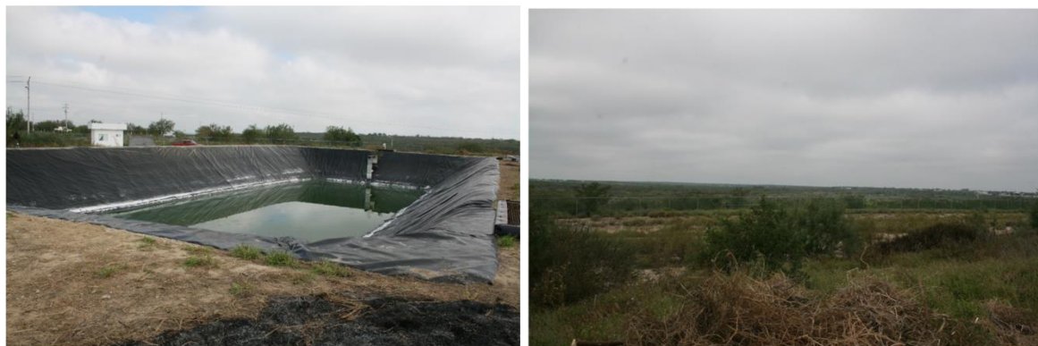
(IZQ) VISTA DE LA LAGUNA ANAEROBIA CON PROBLEMAS DE FILTRACIÓN DE LAS AR. (DER) REGIÓN ALEDAÑA A LAS LAGUNAS.
