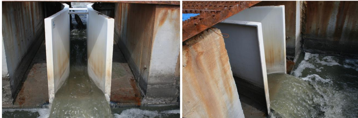
(IZQ) CANAL PARSHALL PARA EL AFORO DE AR. (DER) DESCARGA LIBRE DEL CANAL PARSHALL.
