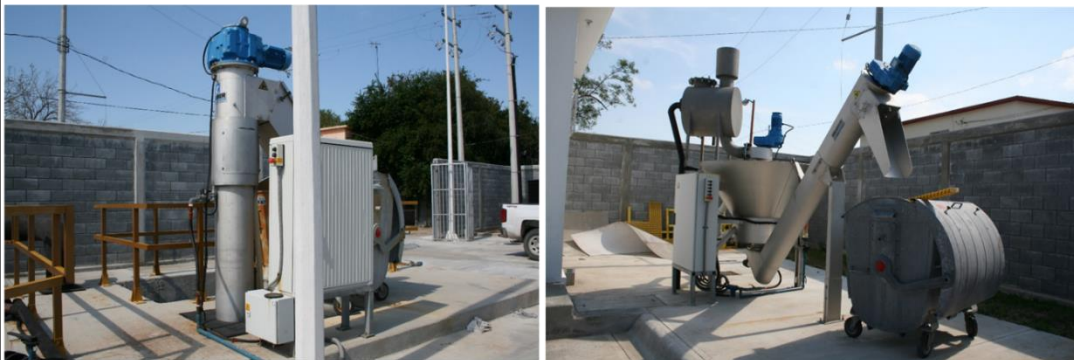
(IZQ) EQUIPO DE CRIBADO DE AR. (DER) DESARENADOR DE AR.
