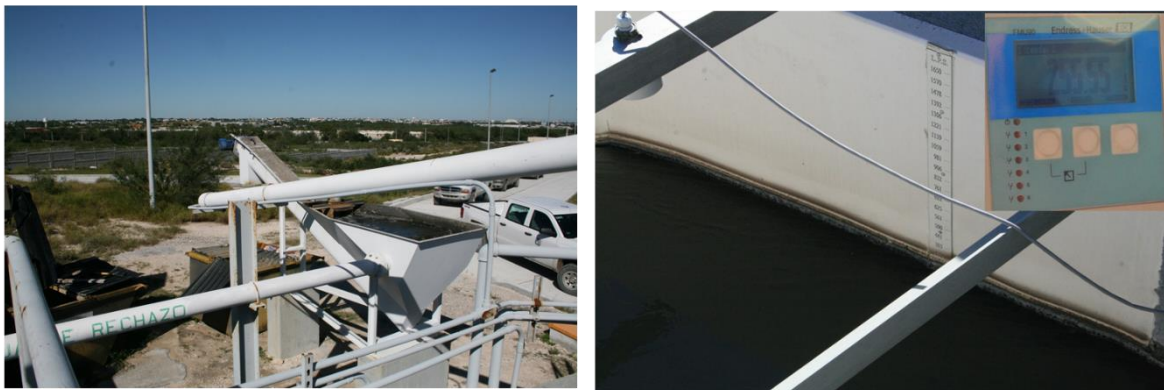
CLASIFICADOR DE ARENAS Y MEDIRO PARSHALL PARA AFORAR EL GASTO DE AGUA RESIDUAL A LOS SEDIMENTADORES PRIMARIOS
