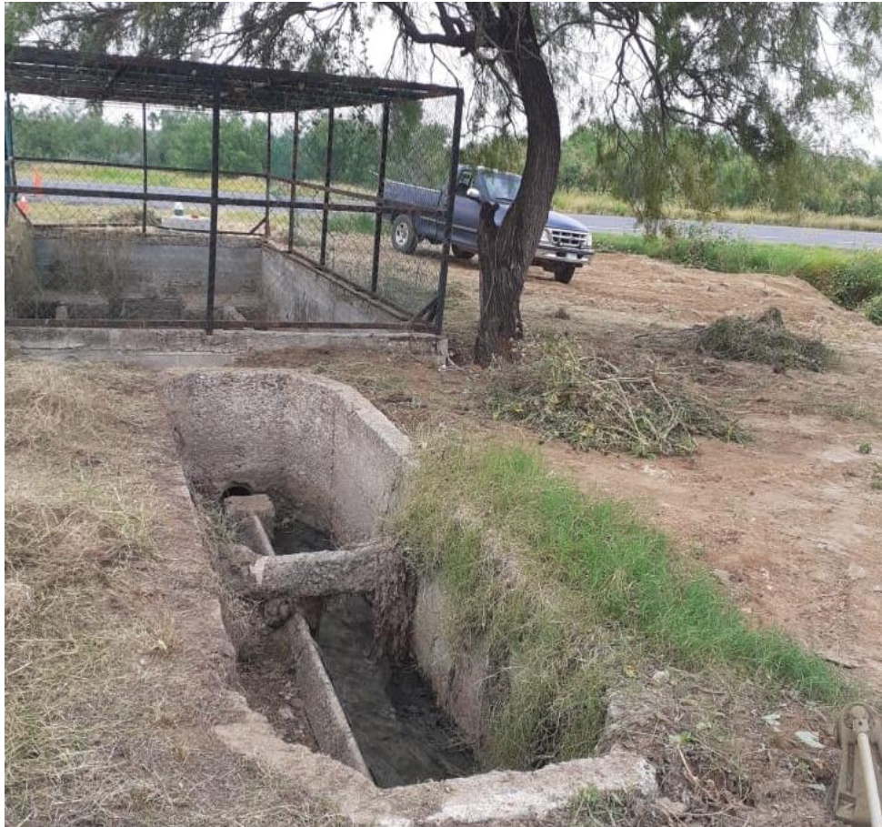
Ilustración 41 Vista del estado actual del tanque Imhoff de Nueva ciudad Guerrero, TM.
