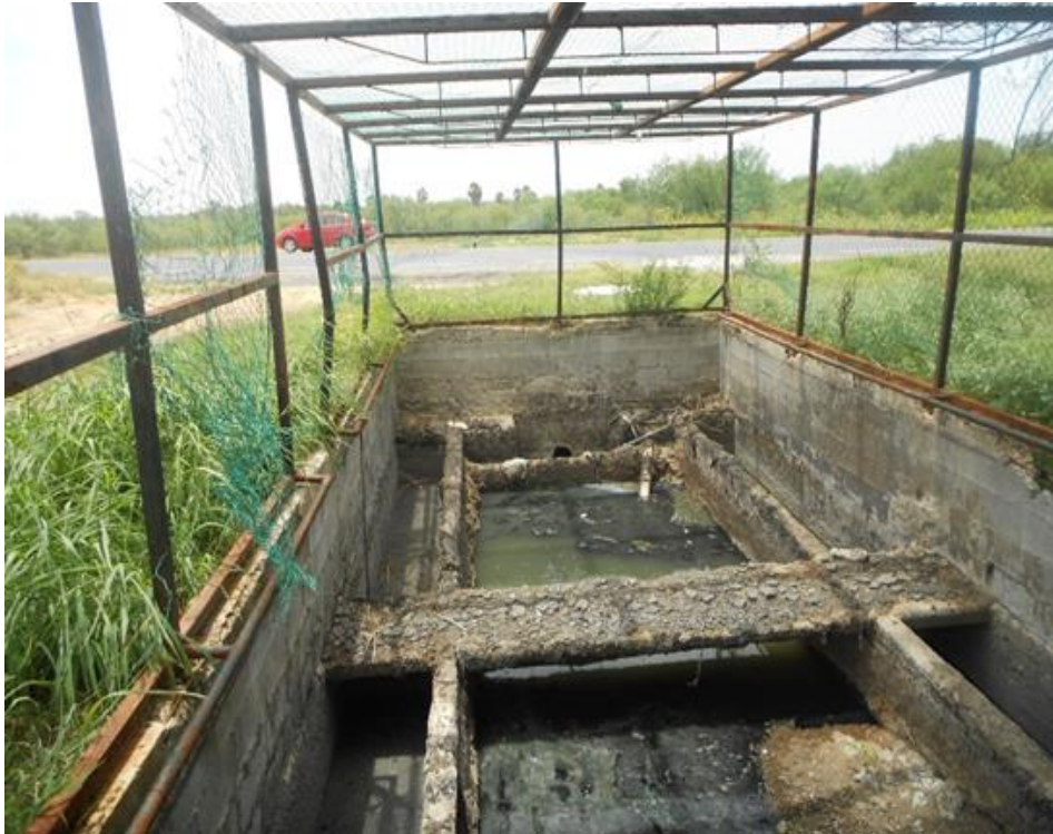
Ilustración 22 Tanque Imhoff fuera de servicio en Nueva Ciudad Guerrero, TM.
