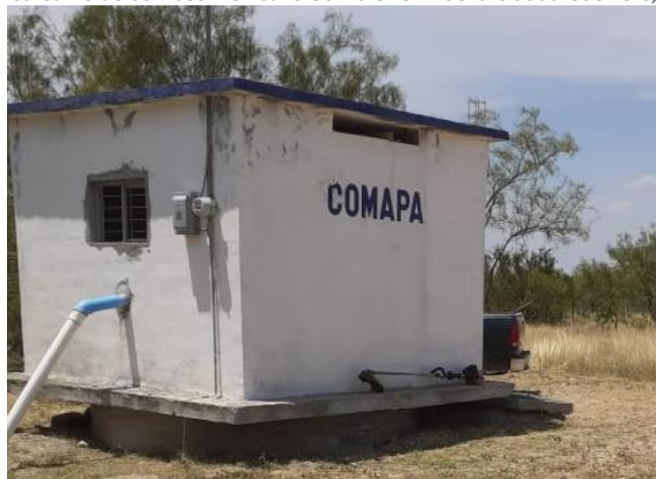
Ilustración36 Cárcamo de bombeo 2 en calle González en Nueva Ciudad Guerrero, TM.
