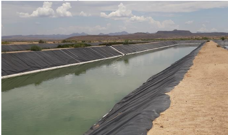
Ilustración 9. Vista de una laguna facultativa de la PTAR, mostrando evidente deterioro.
