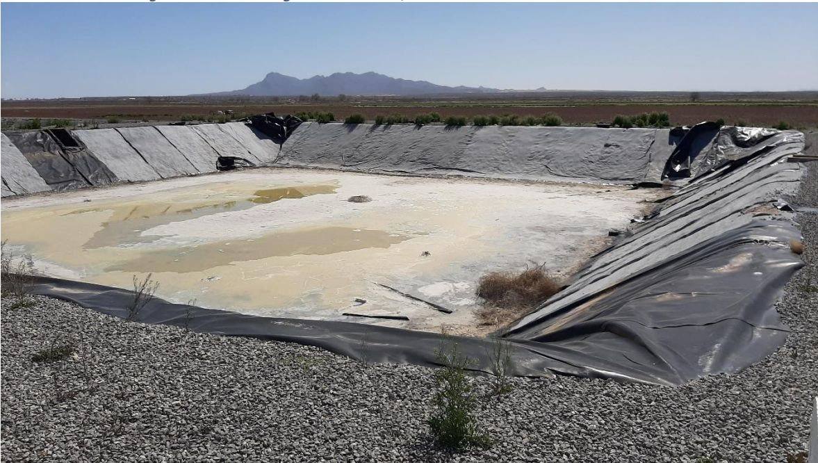
Ilustración25. Vista general de una Laguna anaerobia, mostrando deterioro evidente.
