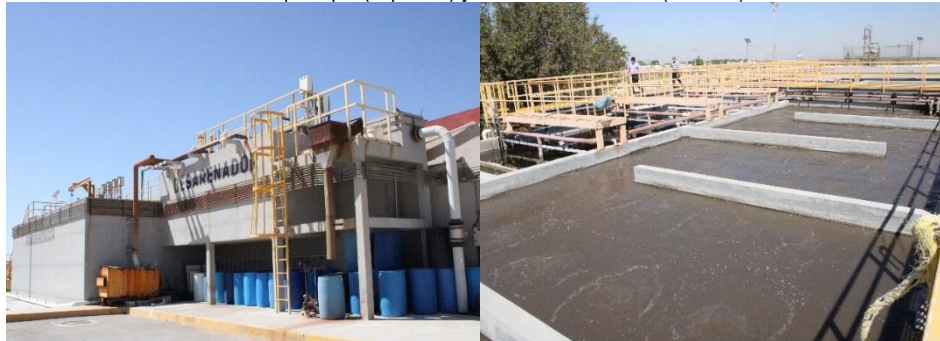
Desarenador y tanque homogenizador (izquierda) y bioreactor A (derecha)
