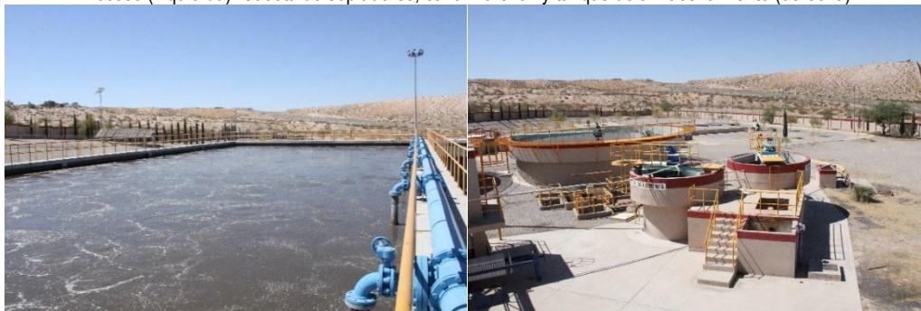
Bioreactor (izquierda). Espesador de lodos (1er plano) y decantación secundaria (2do. plano) (derecha)
