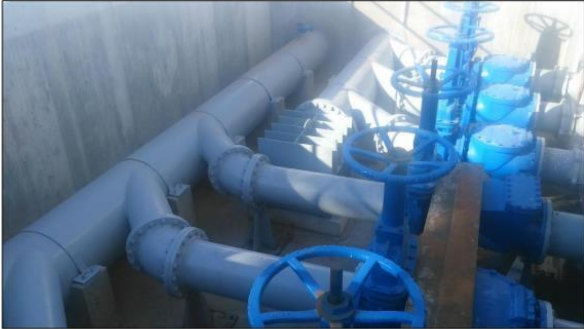
Ilustración 17. Arreglo de equipos en el Cárcamo Sur, San Luis Río Colorado, Son
