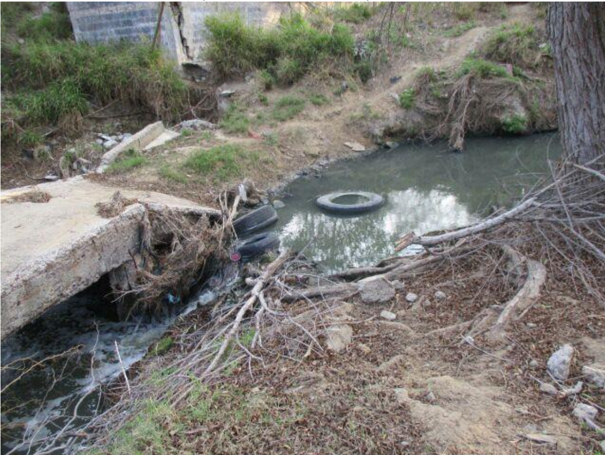
Ilustración 38. Subcolector Coyote Alto, calle de Los Pilotos y Mar de Plata, Nuevo Laredo, TM.
