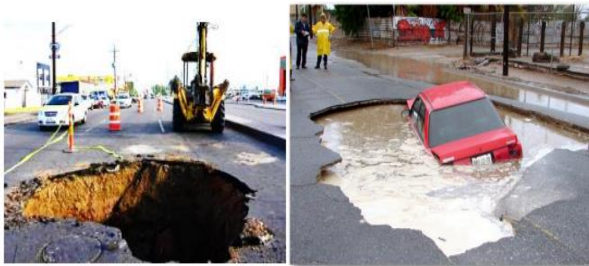
Ilustración 36. Tuberías colapsadas causan socavones y hundimientos en las calles, Mexicali, BC.
