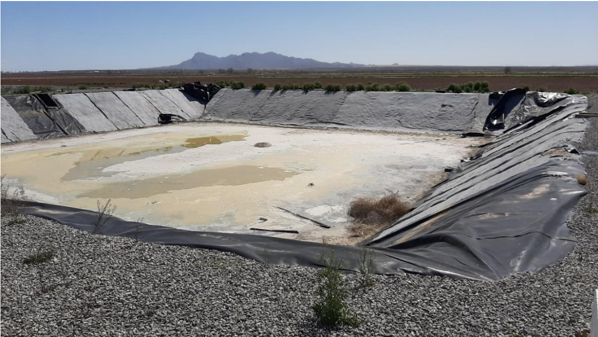
Ilustración 37. Laguna Anaerobia mostrando deterioro evidente, Valle de Juárez, CH.
