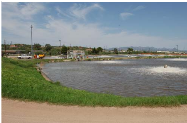
Planta Internacional de Tratamiento de Aguas Residuales (PITARN) en Nogales, Ariz.
