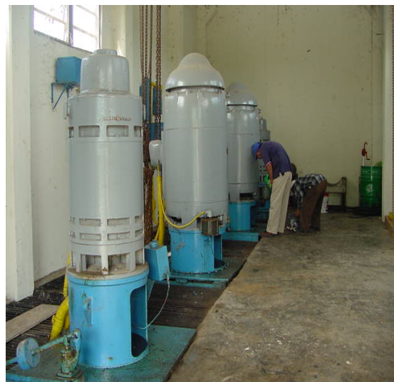
Estación de Bombeo en el Dren el Morillo.
